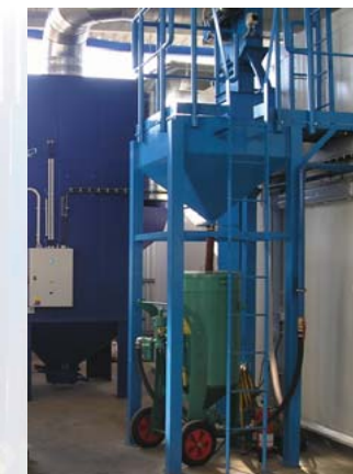
Die Technologische Ausstattung der Strahlräumlichkeiten besteht aus einem Becherförderer, einem Rotationssortierer, einem Strahlmittelbehälter, einem Druckkessel und einem Absaugungsfilter
