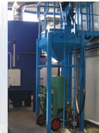
Технологическое оснащение установки струйной обработки включает ковшевый конвейер, ротационную сортировку, накопитель, напорный котел и фильтр вытяжки
